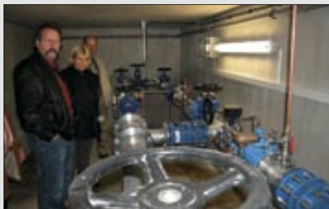
Im Keller der neuen Übergabestation kommt das Wasser aus dem Harz an. Bei der Inbetriebnahme am Dienstag war ein Blick in diesen ansonsten verschlossenen Bereich möglich. Foto: Duhme
