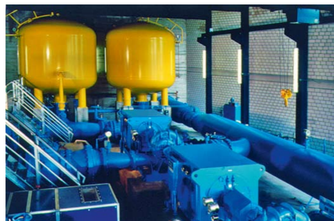
Pumpstation an der Innerstetalsperre
